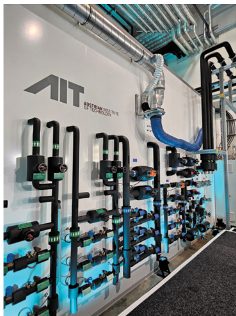
Mit einer Investition von drei Mio. Euro wurden am AIT Austrian Institute of Technology neue Wärmepumpenprüfstände eingerichtet, die realitätsnahe Tests bis 100 kW Heizleistung ermöglichen.
